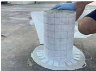
Einer von zahlreichen Lüftern, der nun wirksam gegen die Witterungsbedingungen geschützt ist.
