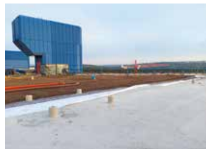
Zum Schutz der Abdichtung verlegten die Verarbeiter Schutzvlies (300 g/m 2 ), auf das der Kies wieder aufgebracht wurde.
