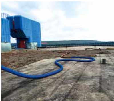
Die Oberfläche des Daches wurde abgesaugt und anschließend mit dem Hochdruckreiniger vorbereitet.
