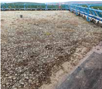
Bevor die Verarbeiter starteten, wurde das Dach von sämtlichen Kieselsteinen und sonstigem Schmutz befreit.
