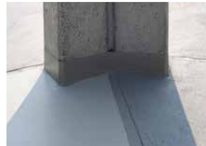
Die Dehnstrecken über den Fugen wurden ca. 10 cm ausgespart. So entstand eine saubere Optik, die gleichzeitig zur leichteren Wasserführung dient.
